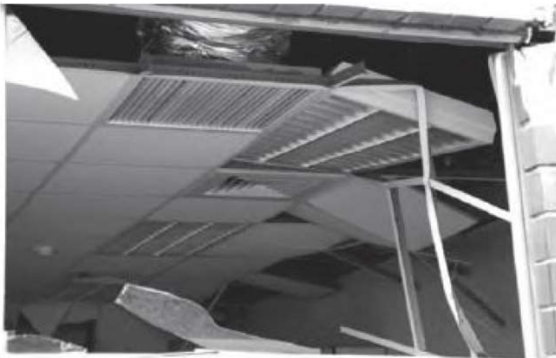
جدا شدن دریچه پخش هوا از سقف در اثر زلزله
