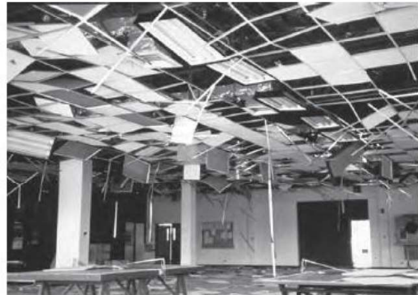
نمونه‌ای از خسارات وارد شده به سقف‌های کاذب در زلزله تایوان
