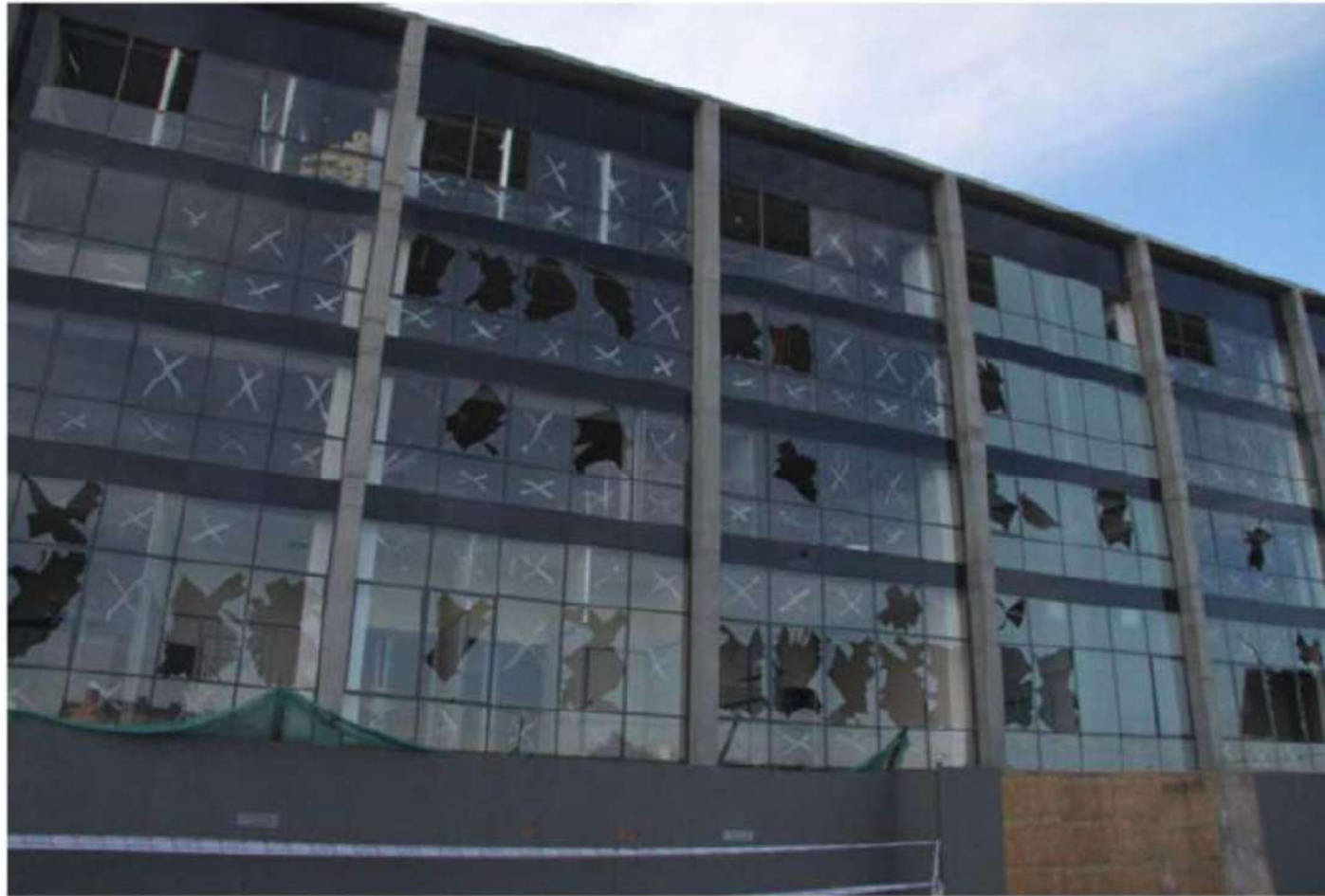
شکل پ ۱-۲- آسیب وارده به نماهای شیشه‌ای در بیمارستان واقع در مرکز شیلی در زلزله ۲۰۱۰ شیلی، بزرگا ۸/۸ منبع: نشریه ۷۴۳
